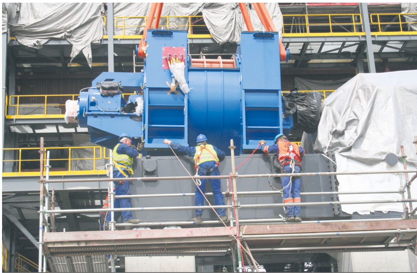
Turbozespół EcoGeneratora powstał w czeskim Brnie. Jego producentem jest firma Ekol. Na zdjęciu: montaż turbiny.
